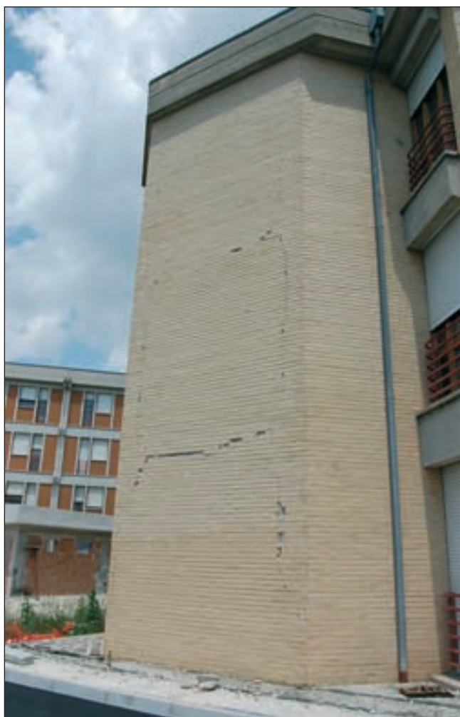
Mura perimetrali dell'ospedale S. Salvatore danneggiate dal sisma aquilano
